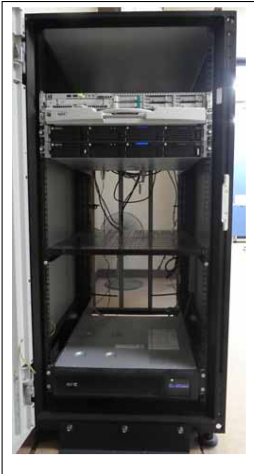
サーバーラック (正面)
