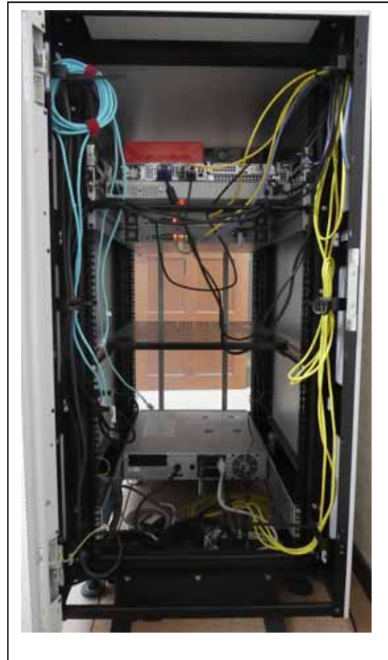
サーバーラック (背面)
